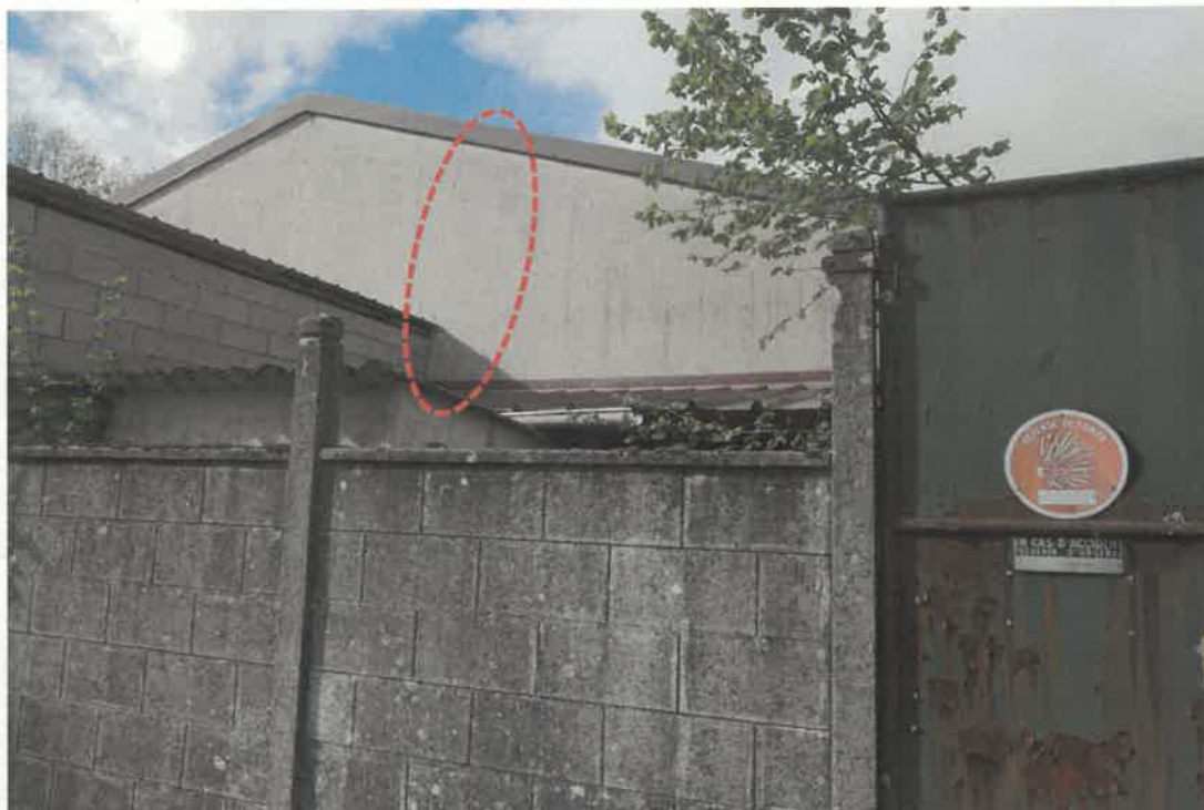
Figure 14 –Façades fissurées au début du chemin de la Villa des Roses
